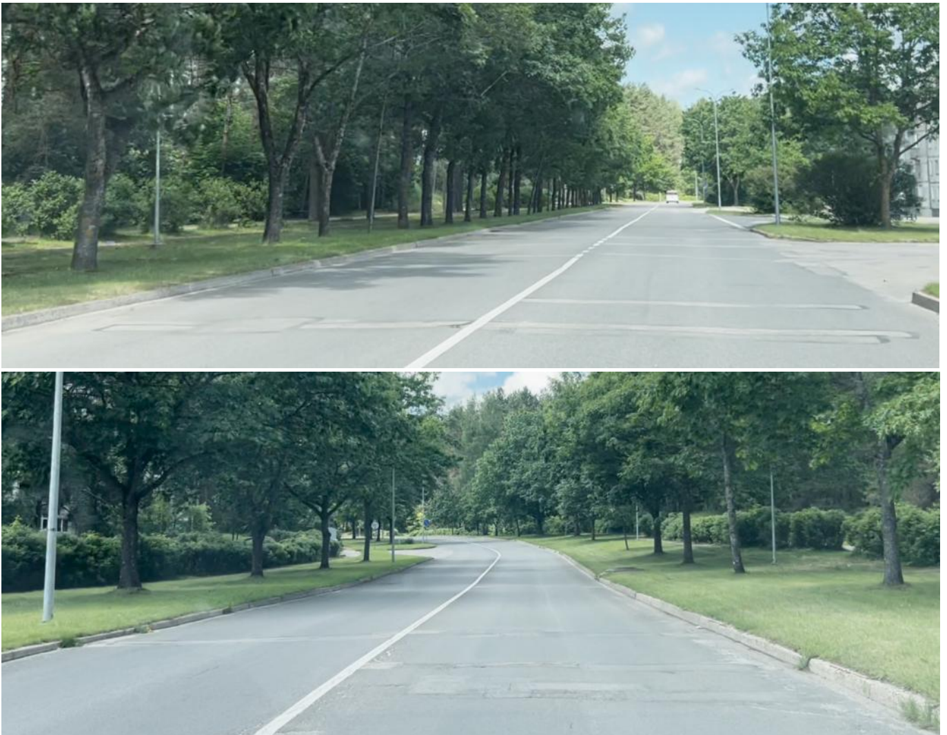
2 pav. Važiuojamosios dalies asfalto dangos pažaidos, 2025 m birželio mėn.
